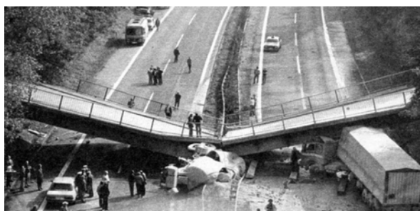
srušen nadvožnjak u Njemačkoj zbog udara kamiona u središnji stup
